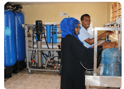
Solarbetriebene Wasseraufbereitung in Kenia
